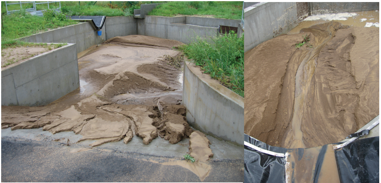
Photo 10. Vue du bassin d'orage suite à la pluie du 14 juillet 2010.
